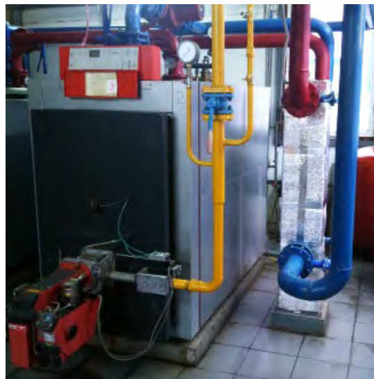
Промышленный котел ТИПОГРАФИЯ, г.Подольск, МО
