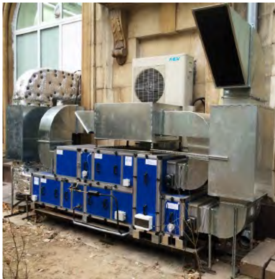
Приточно-вытяжная вентиляция с рекуперацией тепла Поварская ул., Москва
