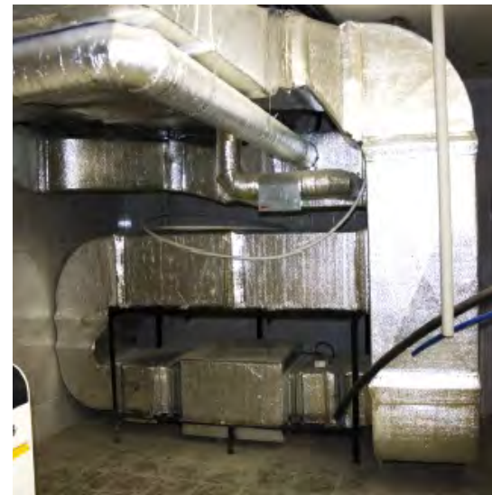
Вентиляция бассейна ЖК «Пестово», МО
