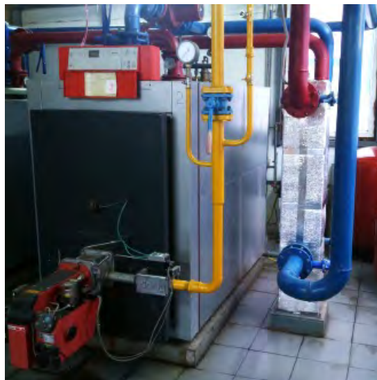
Промышленный котел ТИПОГРАФИЯ, г.Подольск, МО
