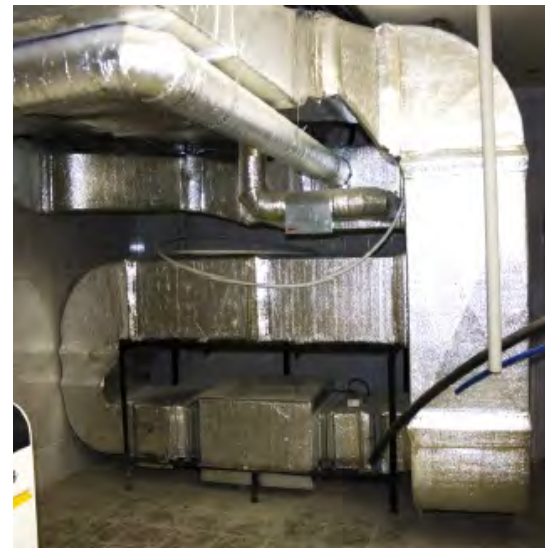
Вентиляция бассейна ЖК «Пестово», МО
